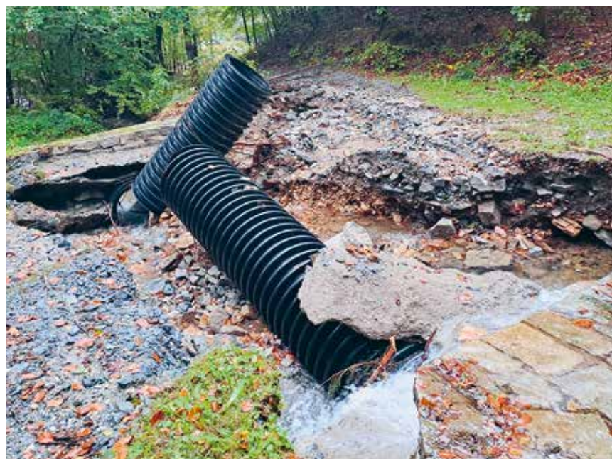
Poškozená propust na LC Lejsalova, revír Mikulovice. Foto: LČR
