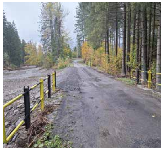
LC Drakovská, nahoře stav po povodni – cca 100m lesní cesty zcela zničeno, oprava (dole) dokončena 11. 10. 2024. Foto: Biskupské lesy BOO
