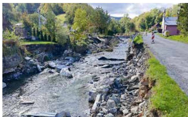
Stříbrný potok – Skorošice – Nýznerov, poškození koryta.
