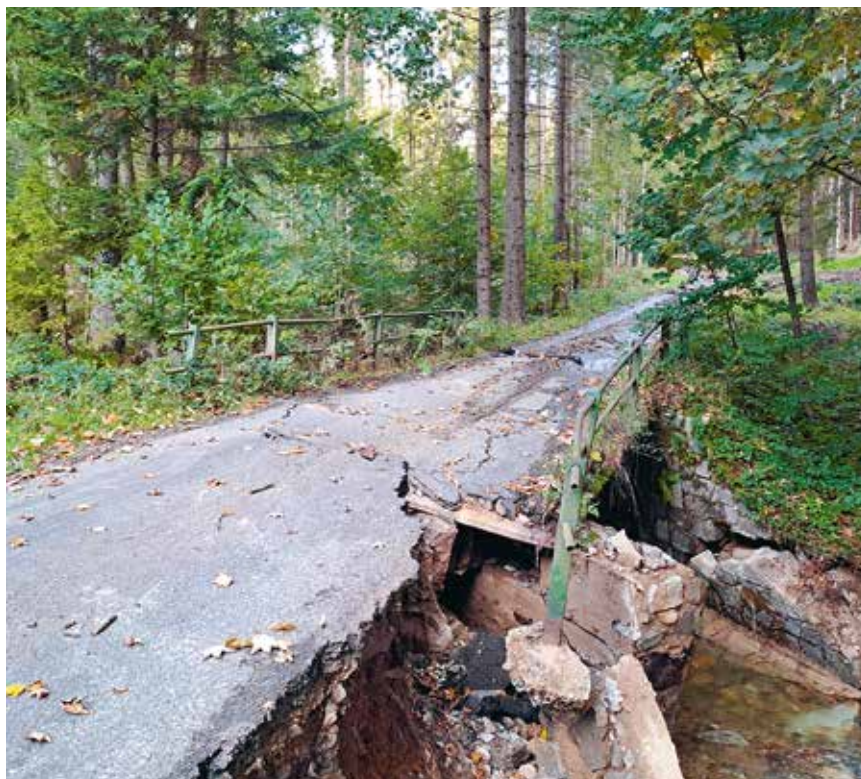
Poškozený most na LC Řetězářenská, revír Jeseník. Foto: LČR
